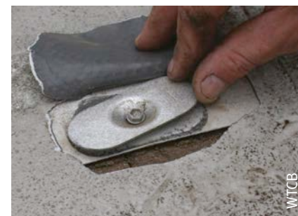
Afb. 103 Onstabiele mechanische bevestiging.
