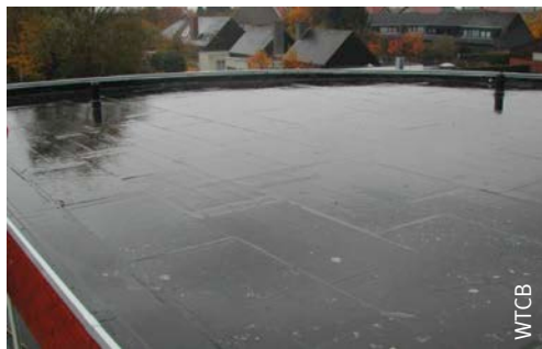
Afb. 120 Aftekening van de randen van de isolatieplaten doorheen de afdichting.
