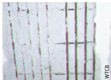
Afb. 101 Beschadiging van een dakvloer uit cellenbeton.
