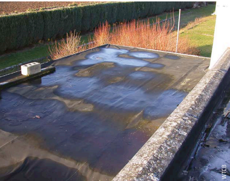
Afb. 28 Koud dak dat beschadigd is door het verrotten van de dakvloer.
