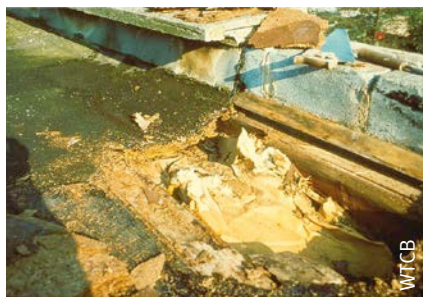
Afb. 113 Schade ten gevolge van inwendige condensatie in een koud dak.
