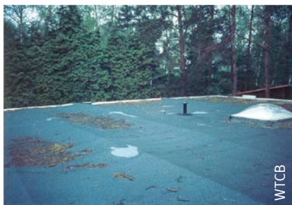
Afb. 112 Schade ten gevolge van inwendige condensatie in een koud dak.
