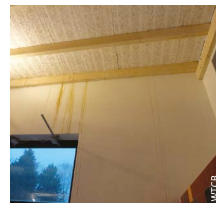
Afb. 118 Druipsporen ten gevolge van vochtlopers langs de dakrand van een zwembad.
