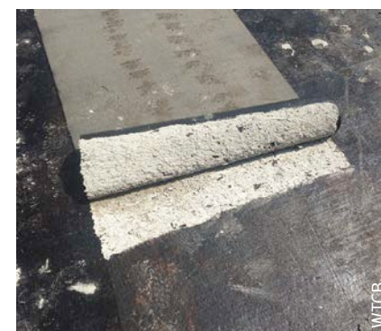
Afb. 111 Gebrekkige oppervlaktecohesie van een lichte cementgebonden afschotlaag.
