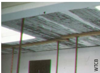
Afb. 100 Beschadiging van een dakvloer uit cellenbeton.
