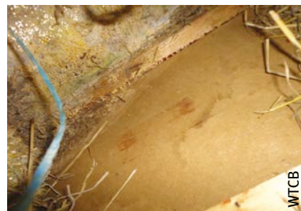
Afb. 114 Schade ten gevolge van inwendige condensatie in een compactdak.
