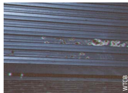
Afb. 102 Corrosie van geprofileerde staalplaten.
