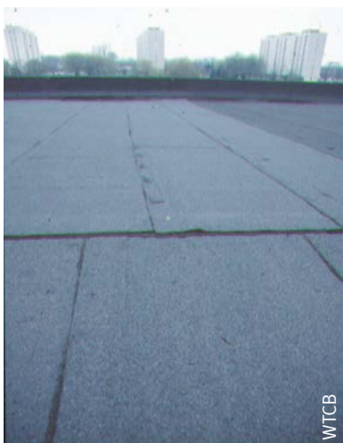
Afb. 125 Ploovorming in een afdichting.
