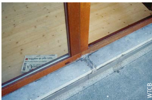
Afb. 129 Ontoereikende hoogte van de opstand.
