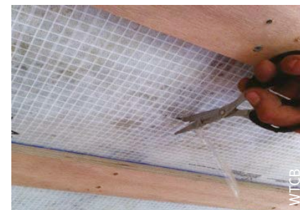
Afb. 115 Schade ten gevolge van inwendige condensatie in een compactdak.
