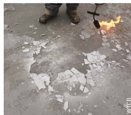
Afb. 110 Gebrekkige oppervlaktecohesie van een lichte cementgebonden afschotlaag.
