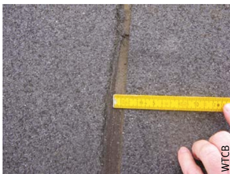
Afb. 128 Krimp van een bitumineuze afdichting.
