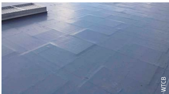
Afb. 119 Aftekening van de randen van de isolatieplaten doorheen de afdichting.
